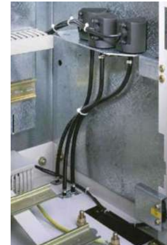
Sistema con interruptor de presión
